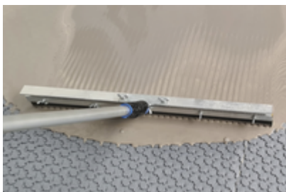
10. Nach Erhärtung der Verklebung kann alternativ eine fließfähige Bodenspachtelmasse (Mindestüberdeckung 3 mm) eingebracht werden ...
